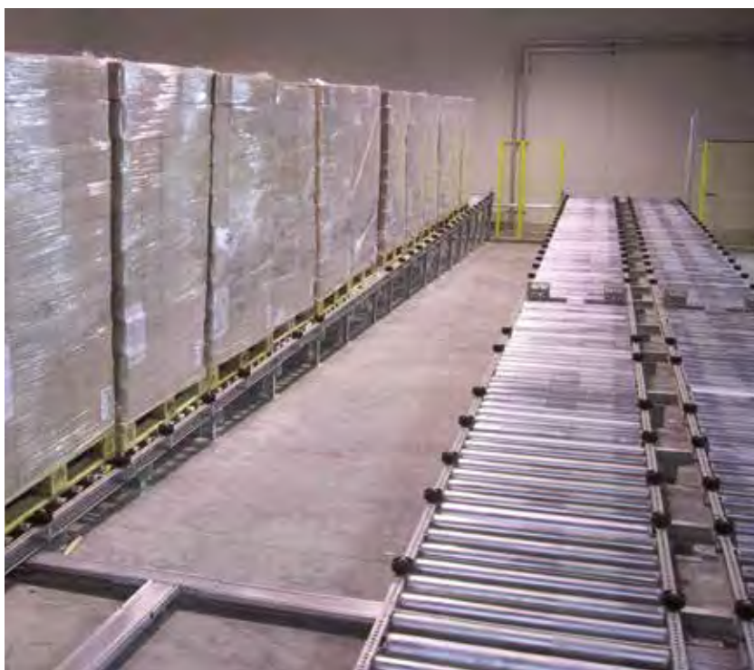
Rulliere a gravità in cella frigo -28°C con separatore intermedio Gravity conveyors in deep freeze storage -28°C with additional separator
