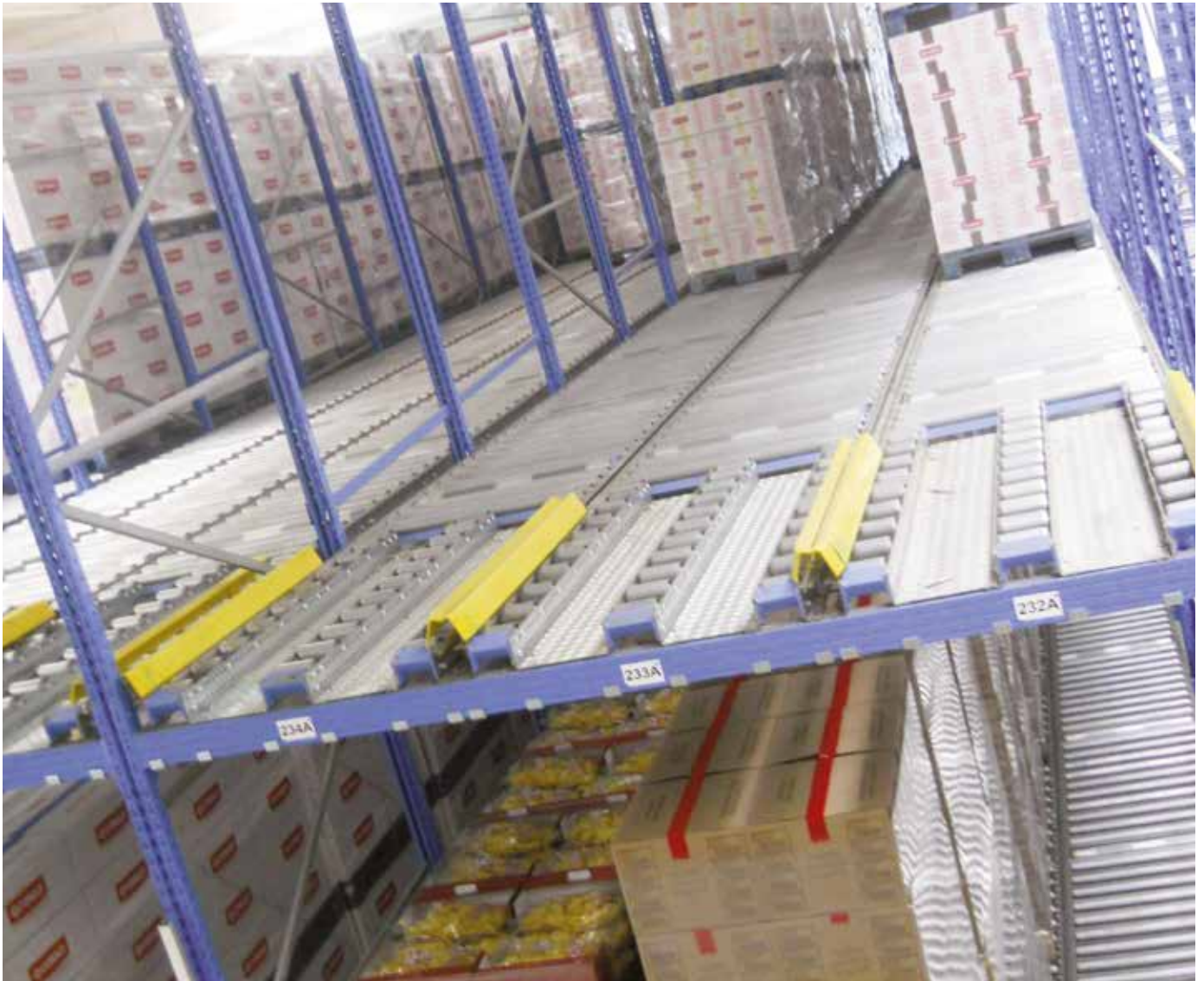
Magazzino dinamico con moduli di carico per AGV / Dynamic warehouse served by AGVs
