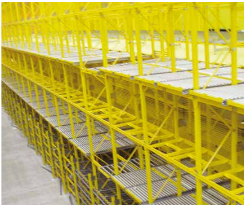
Impianto equipaggiato con rulliere per picking e rullivia riservata al ritorno dei pallets vuoti Shelves equipped with picking roller tracks and conveyor for return of empty pallets
